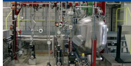
Procesinstallatie in het Edulab
